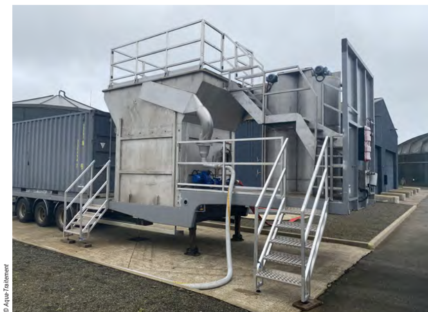
Les améliorations apportées par Aqua-Traitement sont un double bac en entrée pour pouvoir réaliser une coagulation-floculation complète, un système à flux croisé mais avec une trappe réglable, des formes particulières sous le decanqueur et l'ajout d'une herse.
