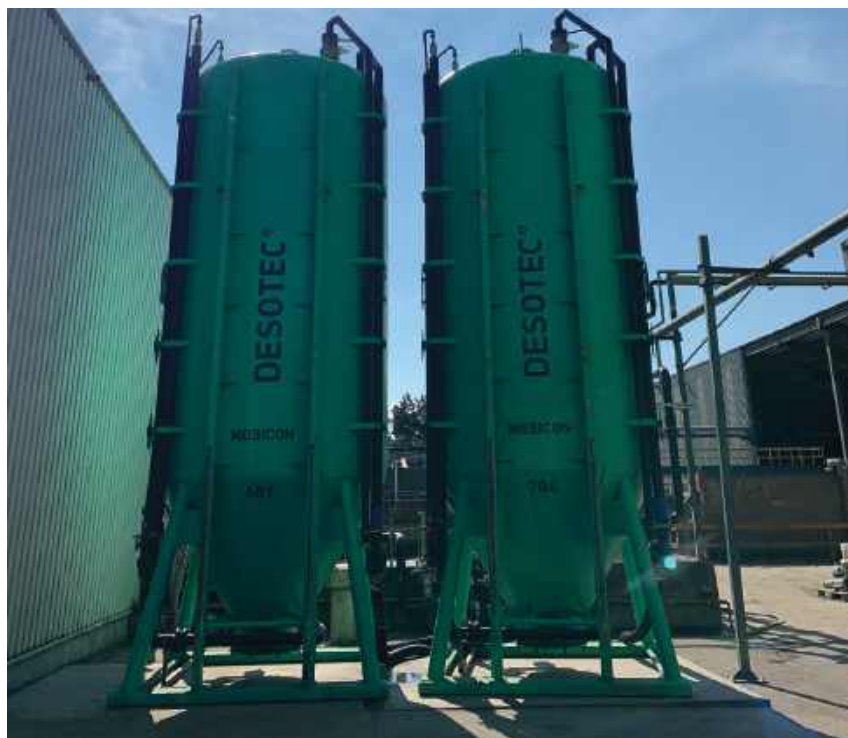
Les filtres à charbon actif prennent peu de place tout en gérant des concentrations et des composants variables.
